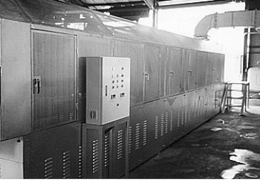
全長約10メートルの炭化炉
