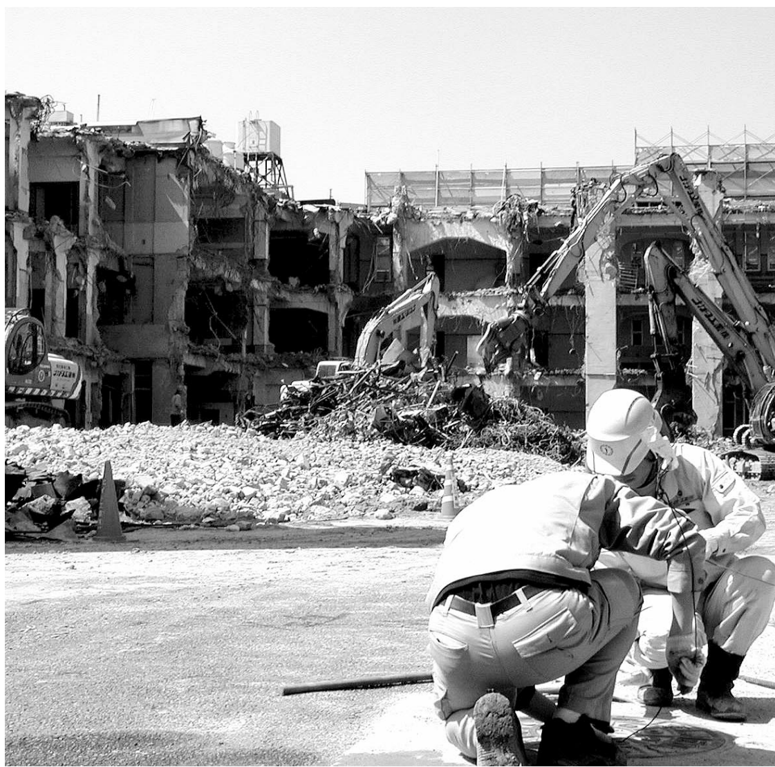
元柳池中学校の校舎解体が進む御池中学校・複合施設の建設予定地。4月中旬から工事は始まり、8月中旬にはさら地になる予定という。取り壊し中の本校舎は後1ヶ月で姿を消し、次は体育館や基礎部分への解体に進む。PFI手法で生まれ変わる施設はどのような街並みを演出できるか。
